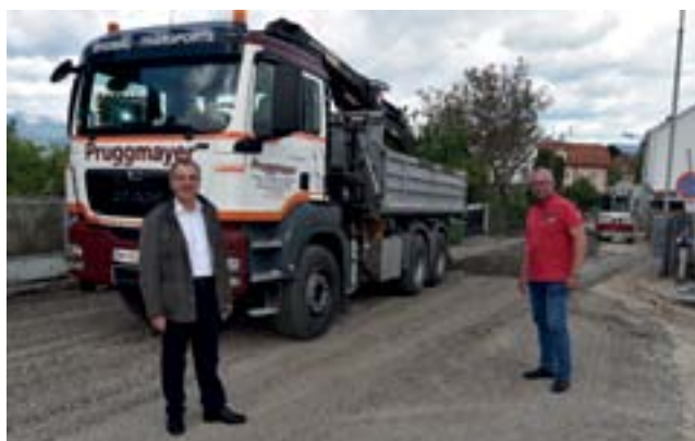
Bürgermeister Rupert Dworak und Stadtrat Gerhard Windbichler bei den Bauarbeiten Danegger Straße
