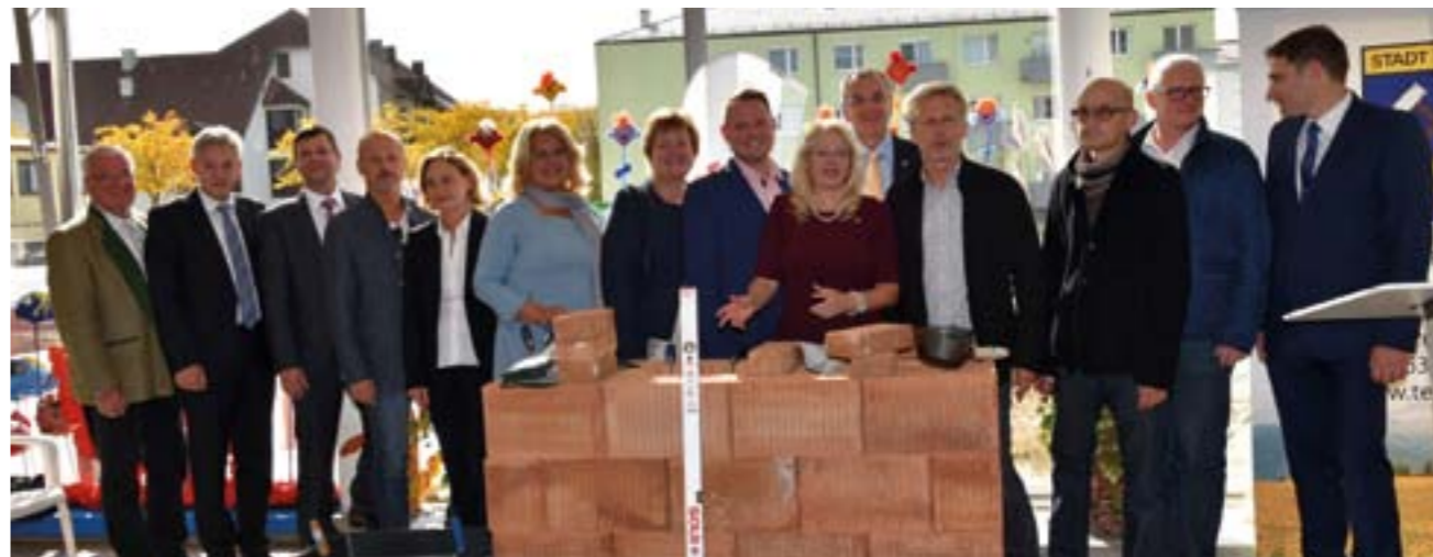
Foto: Der Grundstein ist gelegt! StR Karl Pölzelbauer, LAbg. Hermann Hauer, Prok. Martin Maurer, Bgm. Walter Jeitler, Baumeisterin Ing. Mag. arch. Michaela Kreamsner, Bgm. Mag. Sylvia Kögler, Bgm. Doris Kampichler, Vizebgm. Mag. Christian Samwald, Stadträtin Mag. Andrea Reisenbauer, Bgm. LAbg. Rupert Dworak, die beiden Architekten DI Mario Teynor und DI Josef Schmidt, Stadtrat Peter Spicker, Bezirkshauptmann-Stv. Mag. Martin Hallbauer
