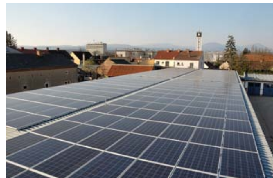
Die Photovoltaikanlage am Städtischen Bauhof ist fertiggestellt und liefert sauberen Strom.
