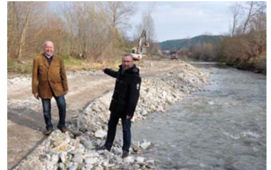
Geschäftsführer Fritz Weninger und Verbandsobmann StR. Gerhard Windbichler sorgen dafür, dass die Schwarza hochwassersicher bleibt.
